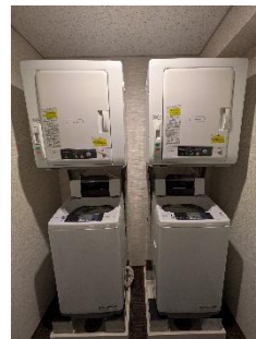
各階ランドリー
