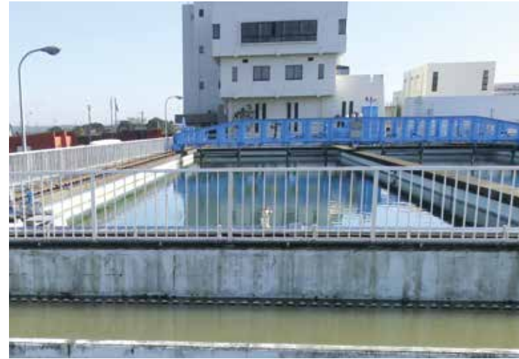
② 大寺浄水場 (木更津)
