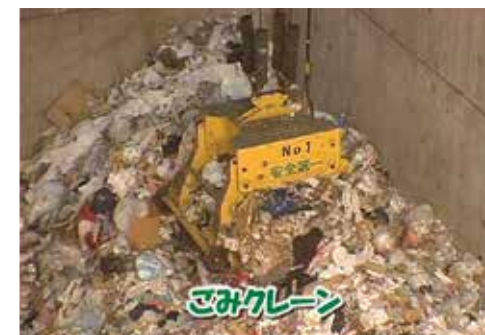
① ごみクレーン
