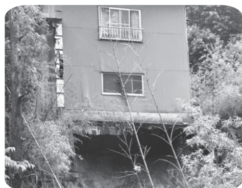
地すべりにより滑落の危険性がある家屋の様子
