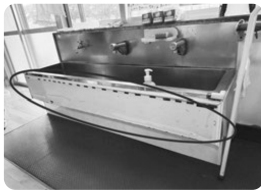
保育室流し台（全面パネルの剥がれ）
