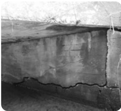
経年劣化により構造体に亀裂が生じている様子
