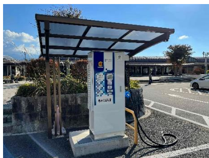
EV 充電設備 イメージ
