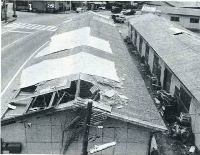
強風で、壊わされてしまった金谷の漁具倉庫の屋根
