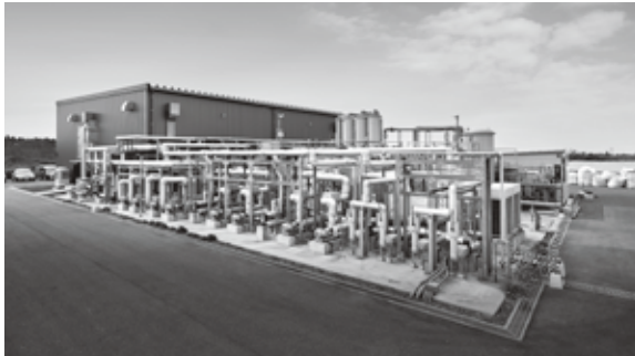
▲汚染物質をバクテリアの力で除去するろ過装置
