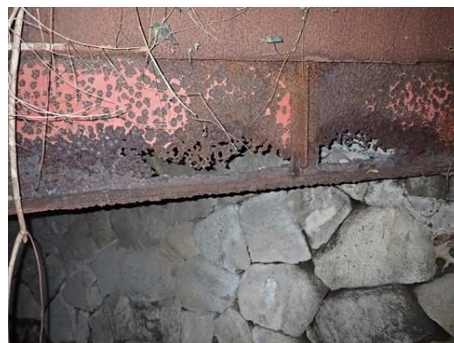
No.172 無名橋 25 主桁の腐食
