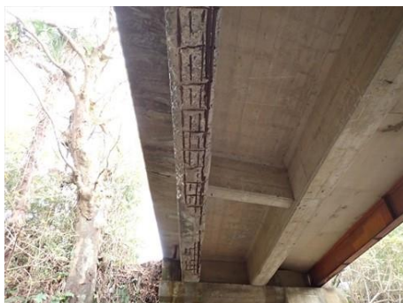
No.165 道滝橋 主桁の剥離・鉄筋露出
