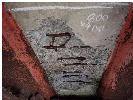
No.130 小久保橋 床版の剥離・鉄筋露出
