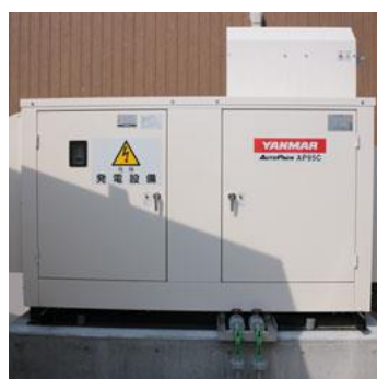
非常用電源 イメージ 出典:道の駅おおさき HP
